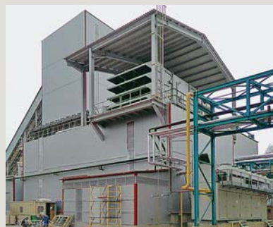
Когенерационная ГТУ LM2500+G4 с дожимной компрессорной установкой типа EGSI-S-100/700WA
