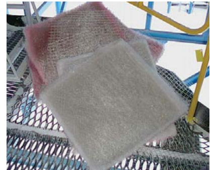
Фото 1. Обмерзание влагоотделителя со стороны ФГО
