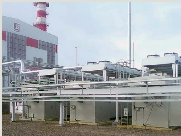
Дожимные компрессорные установки Enerproject
