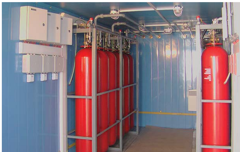
Стойка постоянного контроля утечки \text{CO}_2 в модулях газового пожаротушения
