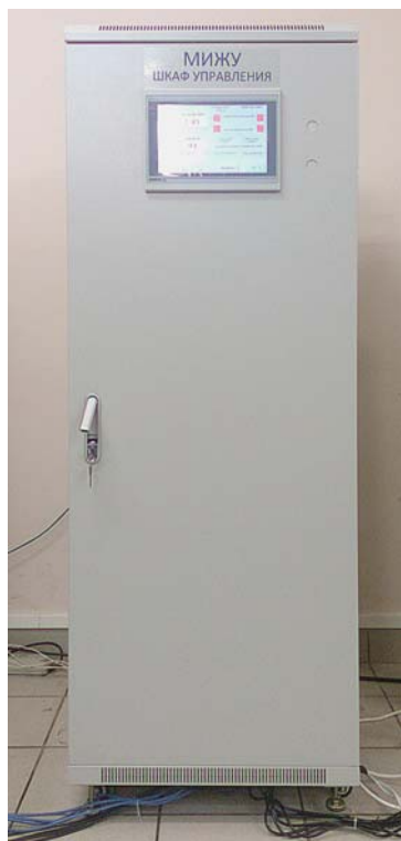
Шкаф управления МИЖУ
