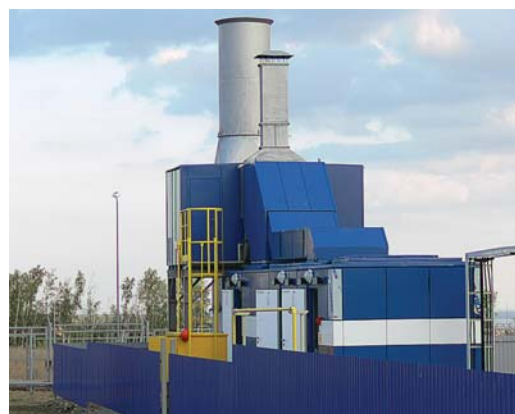
Фото 4. ЭГТЭС «КОРВЕТ-1,7К» КС "Приволжская"
