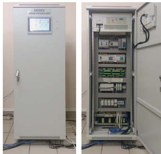
Шкаф управления МИЖУ
