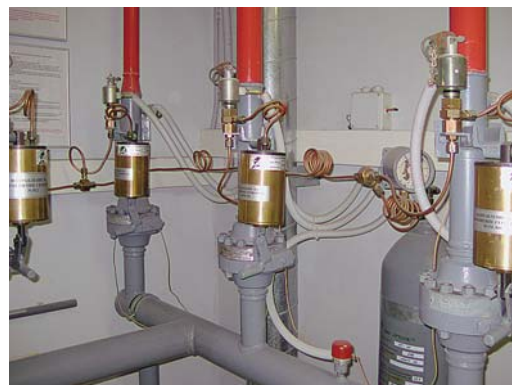
Распределительное реверсивное устройство для подачи газового огнетушащего вещества
