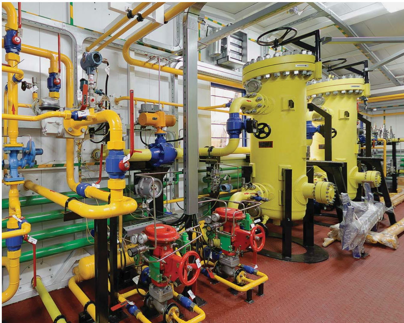
ФК в обвязке (БПГ Юрхаровского МР)
