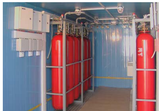
Стойка постоянного контроля утечки CO 2 в модулях газового пожаротушения
