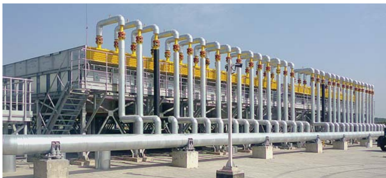
АВО высокого давления «Айсберг-32,0», КС «Русская»
