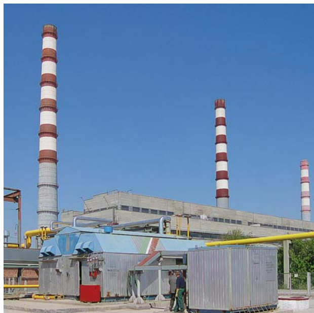
Фото 6. Дожимная компрессорная станция ЗГЦ2-38/9,5-28КУ1 на ТЭЦ-9 Мосэнерго
